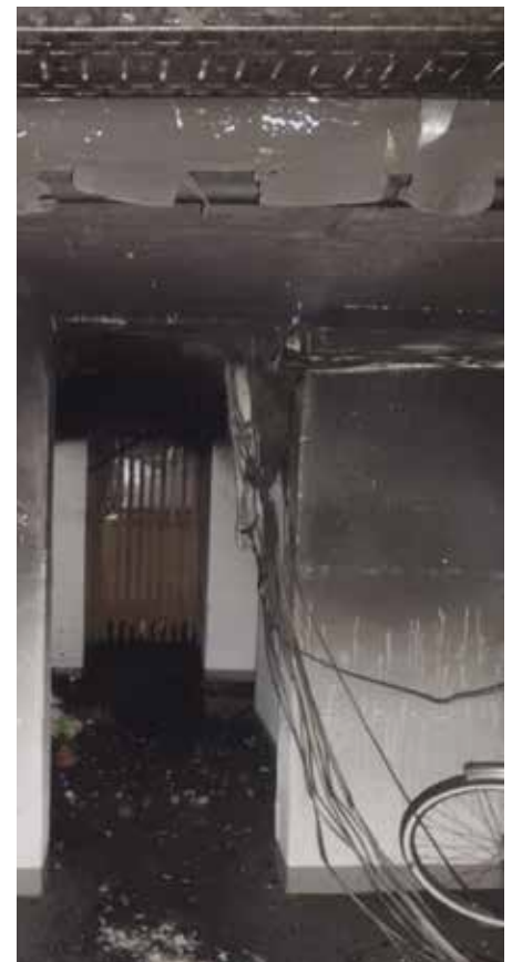
Der ganze Keller wurde in Mitleidenschaft gezogen.
