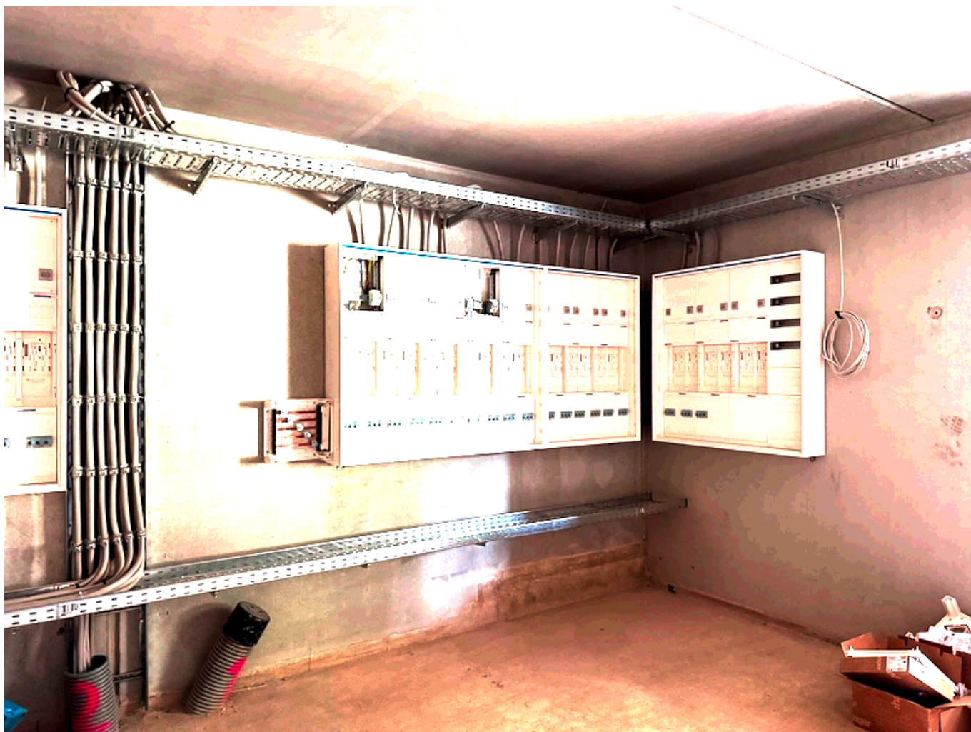
Auch die technische Ausstattung der Gebäude nimmt Gestalt an: Elektroverteilungen und Leitungsführungen sind in diesem Raum bereits installiert. © Baugenossenschaft Dormagen eG
